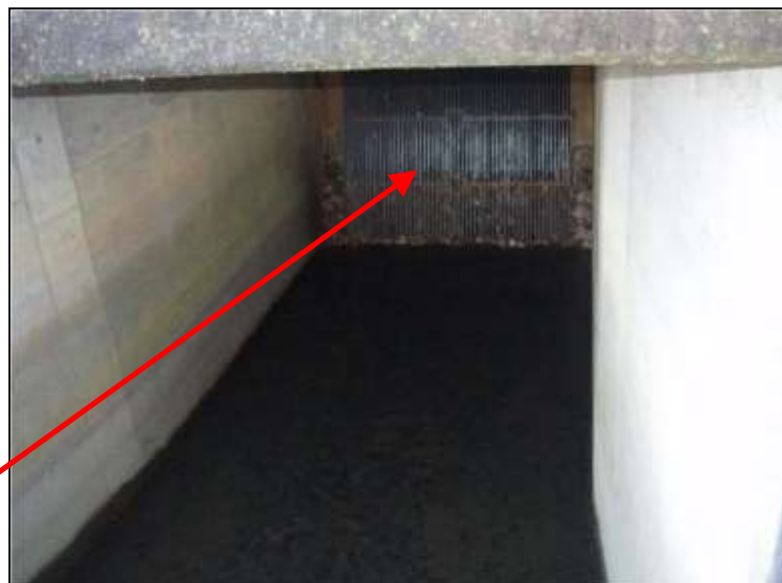
葛巻雨水ポンプ場
