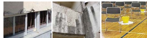
↑ 崩壊や雨漏りしている校舎の壁。卒業式で雨漏りが発生しました。
