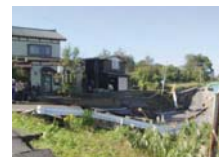
▲崩落した県道見附栃尾線
