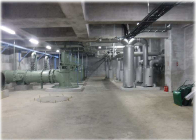
○ 葛巻ポンプ場
