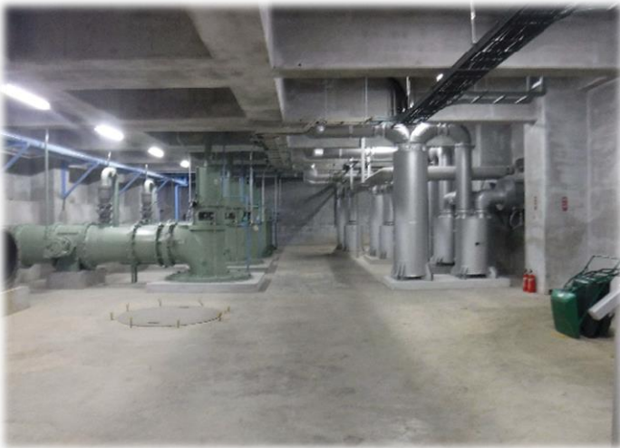
○ 葛巻ポンプ場
