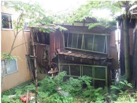
危険な空き家
