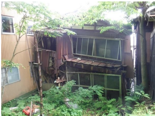
危険な空き家
