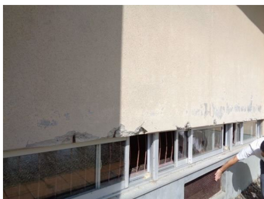
コンクリート爆裂により鉄筋が露出した体育館外壁
