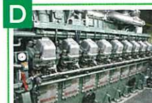
非常用ディーゼル発電機(各号機3台)
