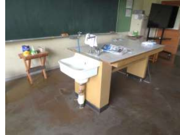
南中 理科室 排水管腐食による破断 により漏水。
