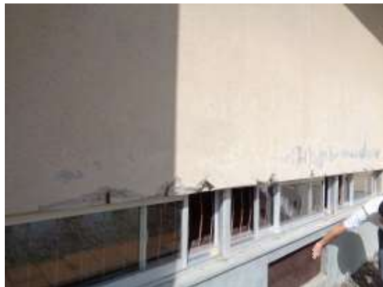
南中 体育館外壁 コンクリート爆裂による 鉄筋露出。
