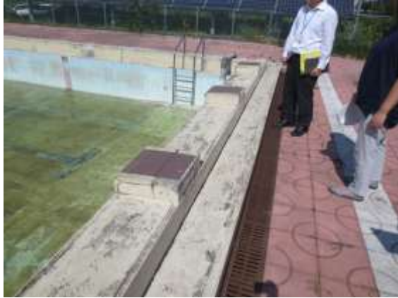
名木野小 プール 壁面老朽化により修繕せず、 市民プールを使用して授業を 実施
