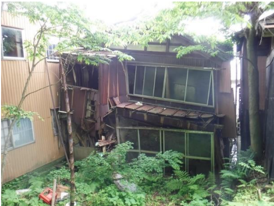
危険な空き家
