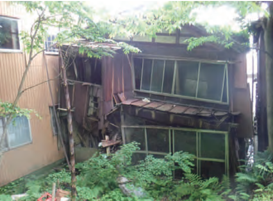
危険な空き家
