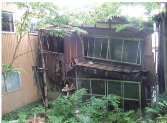
危険な空き家
