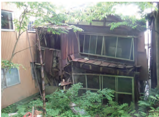
危険な空き家
