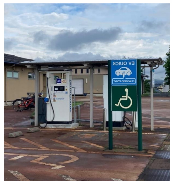
EV 自動車急速充電器
