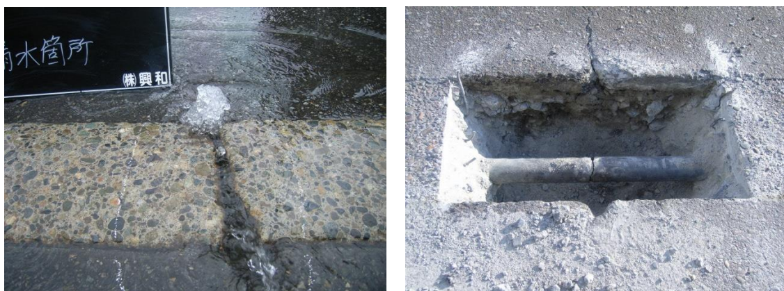
写真 2-1 漏水状況の例（左：漏水状況、右：漏水配管の亀裂部分）
