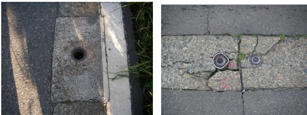
写真 2-5 排泥不良状況の例（左：配管閉塞による排泥不良、右：蓋の破損）
