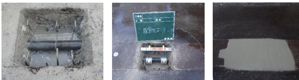
写真 3-1 漏水修繕写真例
