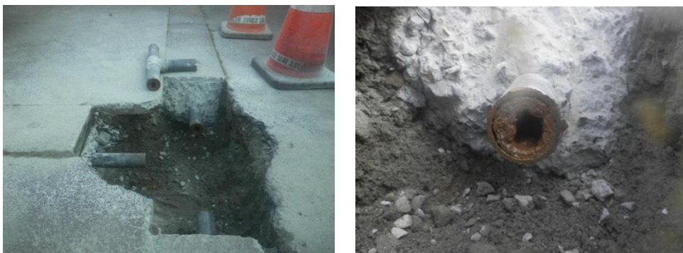
写真 2-6 清掃前の配管閉塞状況 （左：確認のための配管切断、右：配管閉塞状況）
