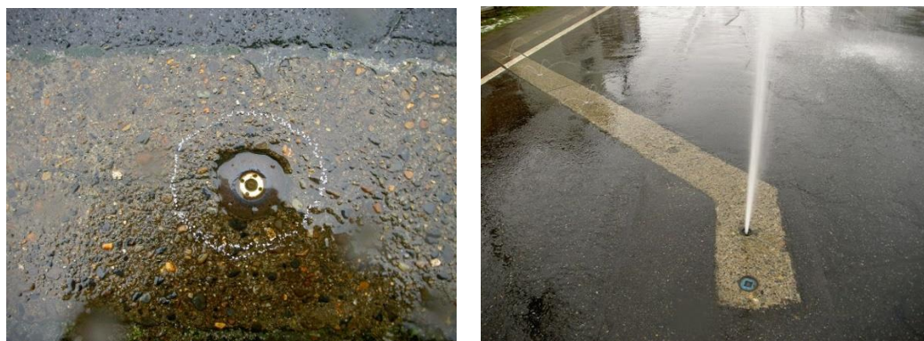
写真 2-3 散水不良・ノズル故障の例（左：散水不良、右：ノズル故障）
