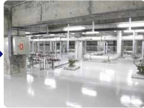
混和槽 薬品を入れて、ろ過しやすい水にします。
