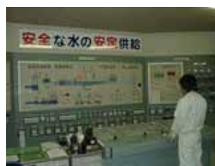
中央監視室（青木浄水場）
